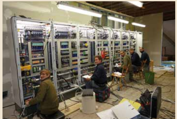
Abb. 3 Umfangreiche Umbauten am Schaltschrank
